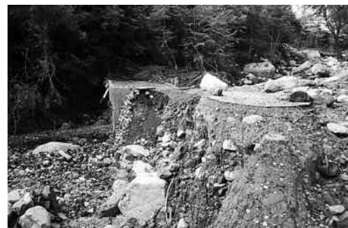
h. 広小橋 (発電所側) の被害
