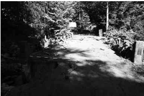
c. 桂小場橋の被害 (右岸側)
