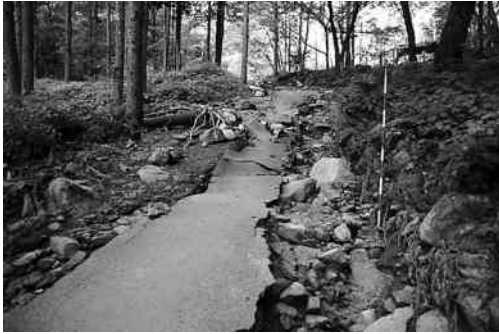
a. つばめ沢橋付近の林道の被害
