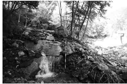
j. 広小橋～ホソ沢橋間の林道の被害
