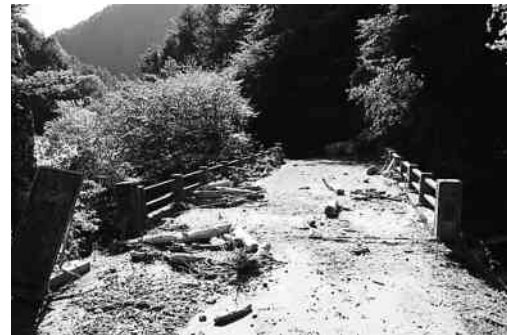
d. 桂小場橋の被害 (左岸側)
