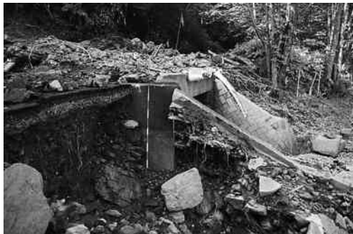
k. ホソ沢橋（小黒川本沢側）の被害
