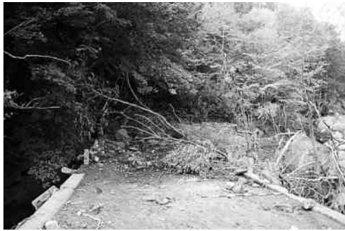
i. 広小橋（右岸側）の土砂堆積
