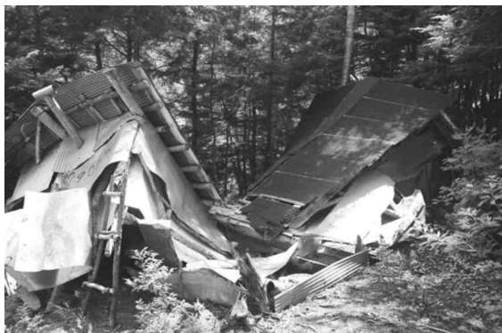
写真3 倒壊した長尾根小屋 (2004年7月撮影)
