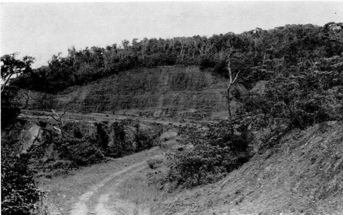
写真3 切取法面の大きいところでは、上部の森林が大きく影響を受けている。
