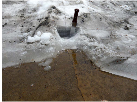
写真4 栄中学校グラウンドで生じた亀裂
