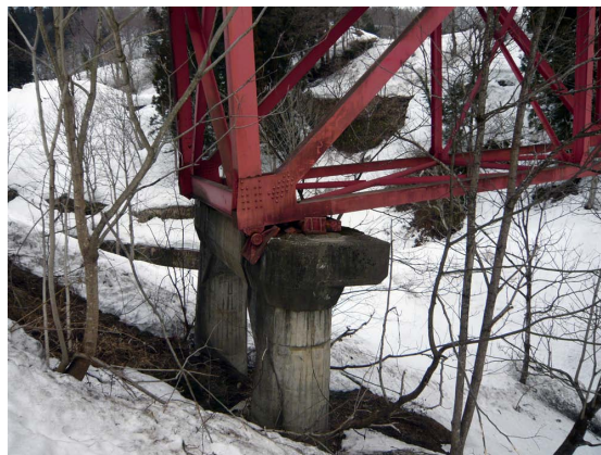
写真8 中条川橋の ししとう 支承のずれ
