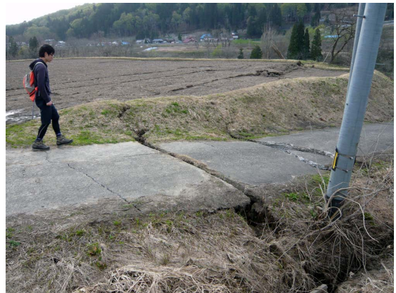
写真 17 地すべりにともなう開口亀裂（小滝地区）
