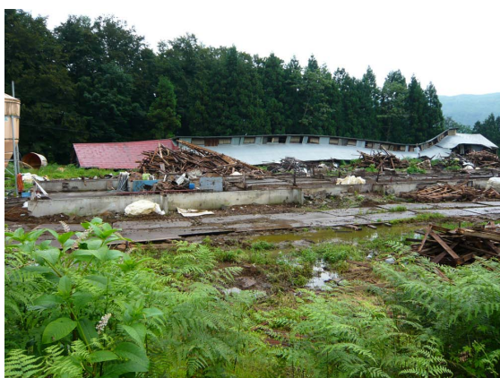
写真23 全壊した養豚場 (泉平地区)
