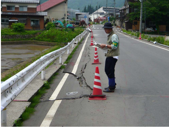
写真 12 擁壁の開きにより生じた路面の開口亀裂（横倉地区）
