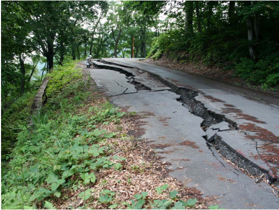
写真 24 平滝地区北側の林道で生じた開口亀裂
