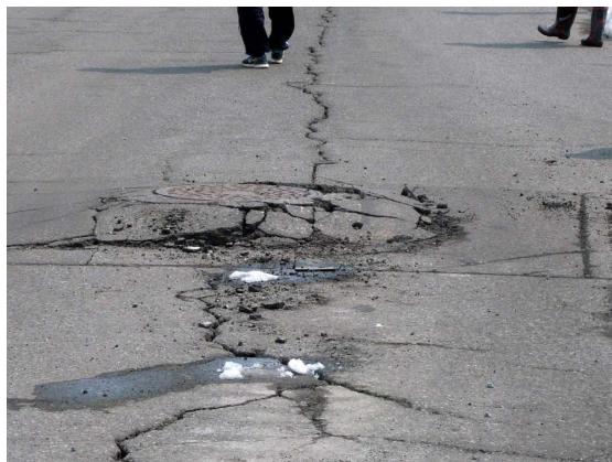
写真6 液状化によるマンホールの抜け上がり(青倉地区)
