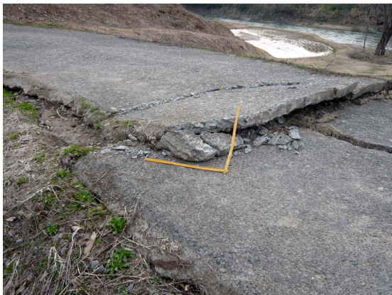
写真 18 地すべりにともなう圧縮性の亀裂（小滝地区）
