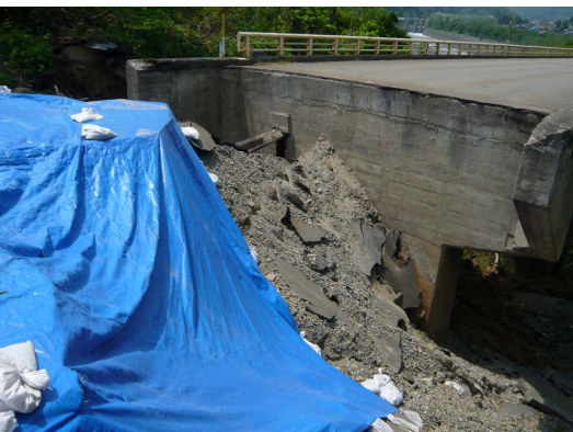
写真 27 境川橋の取り付け部の崩落（左岸側）
