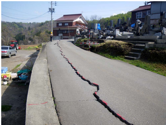
写真 16 擁壁の開きにより生じた路面の開口亀裂と墓地の被害（小滝地区）
