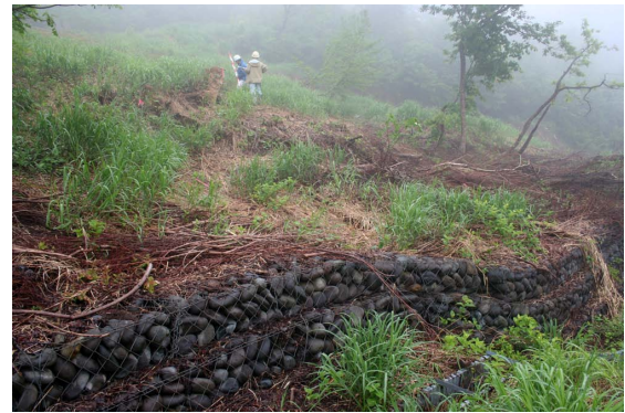
写真30 地すべりの再活動による被害状況 (青倉地区と野々海池間の道路)
