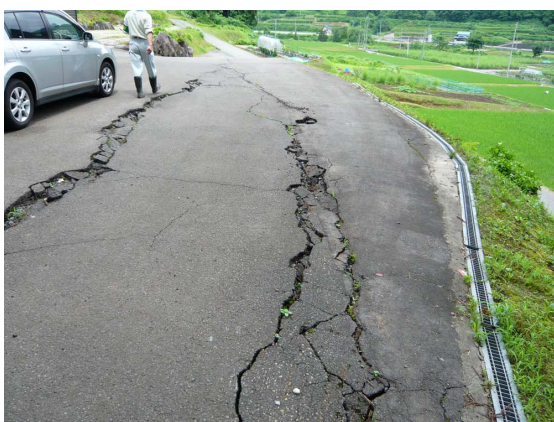
写真22 常慶院で生じた開口亀裂 (蓑作地区)
