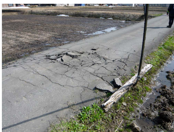
写真9 平坦な場所における圧縮性の亀裂（青倉地区）
