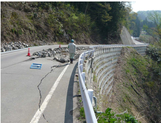
写真 25 擁壁の開きにもなう開口亀裂 (月岡-小滝地区間の道路)
