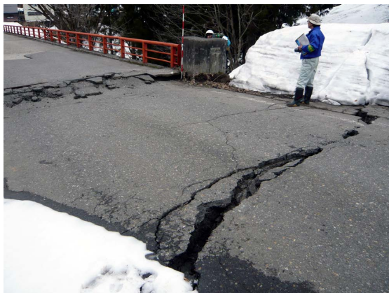
写真7 中条川橋の取り付け部の陥没（左岸側）
