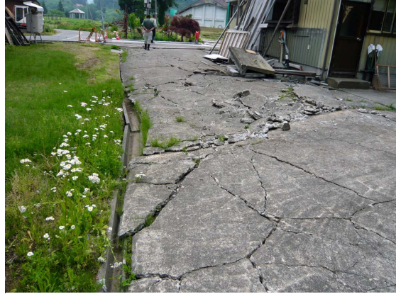
写真 13 平坦な場所における圧縮性の亀裂（横倉地区）
