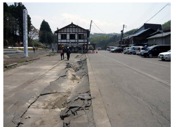
写真2 森宮野原駅周辺で発生した液状化現象による陥没
