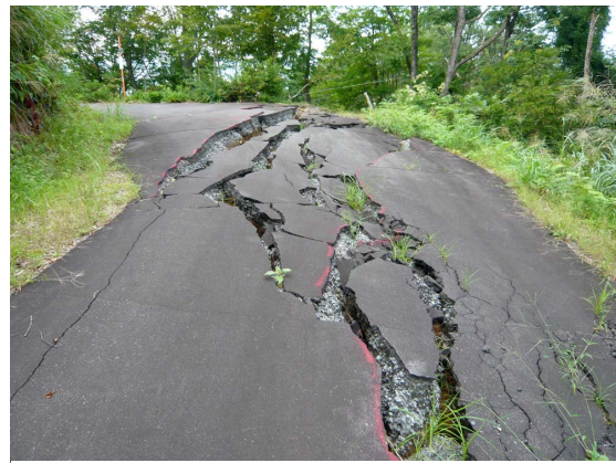
写真 26 地震後に大きく開いた開口亀裂 (赤いマーカーがずれている：小滝地区-奈免沢川間の道路)
