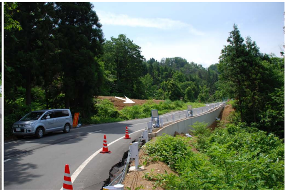
写真9 大巻付近の路面の押し出し (2011年6月20日)
