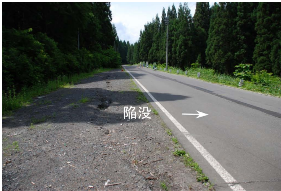
写真8 大久保付近の路面の陥没 (2011年6月20日)
