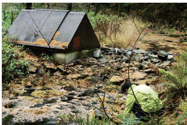
写真2 清水川源流部の取水施設。人物の周辺から水が多量に湧出している。施設右手の石で組んだ取水堰より上は静水域となり、10 m ほど上流で水は途絶える。
