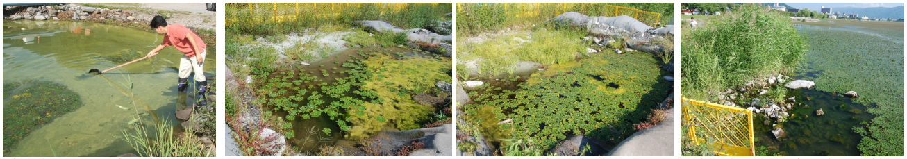
(g-1) No.13 (圍繞堤外) (g-2) ケース1 (g-3) ケース2 (g-4) No.8 (圍繞堤外) (g) 施工180日後 (2008/9/10, 14時: 気温26.7℃, 晴, 風速2m)
