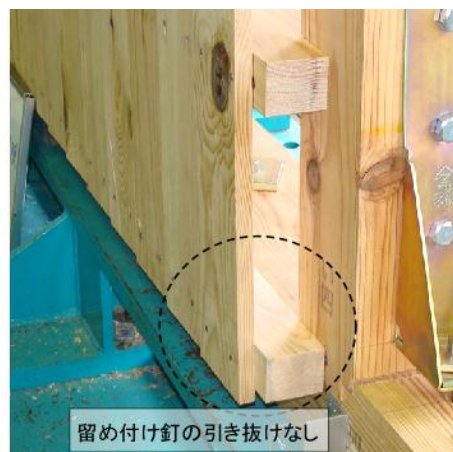
写真 4.1.5 小幅板を用いた床組の破壊形態
