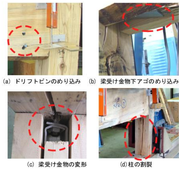
写真 3.3.2 梁受け金物による接合部の破壊形態
