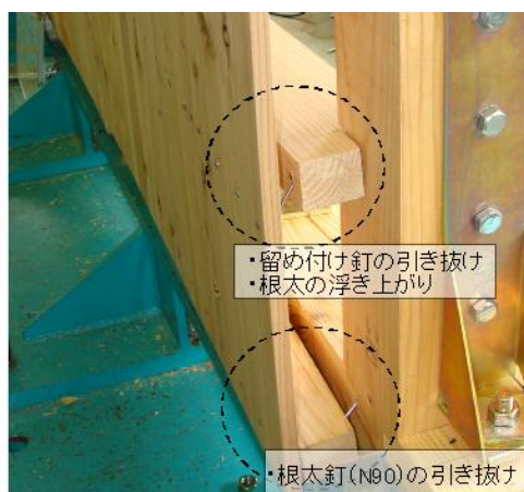
写真 4.1.6 幅はぎ板を用いた床組の破壊形態
