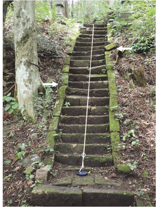
図10 八幡宮石段に生じた変状(地点④)
