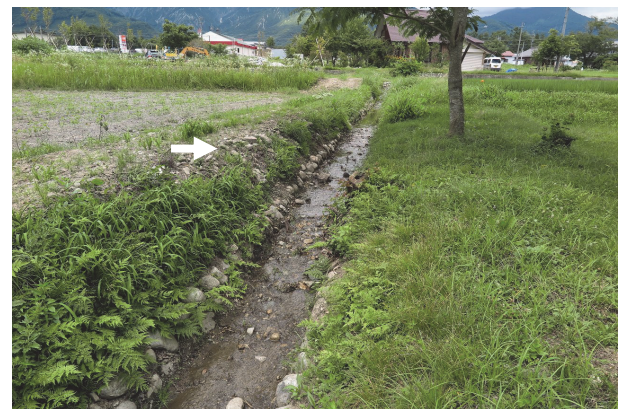
図25 水路の破損(四十九院南)
