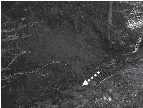
写真5(b) 溪岸崩壊
