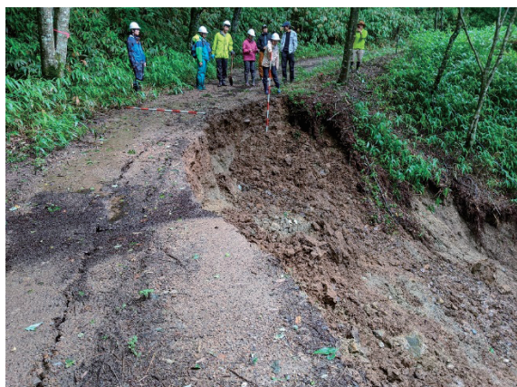
写真1 作業道下流側法面の崩壊
