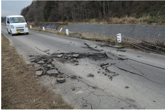
4-6-1 姫川左岸村道の圧縮を示す変状
