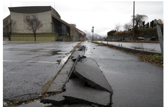
1-10-2 ウイング21南駐車場の圧縮変位
