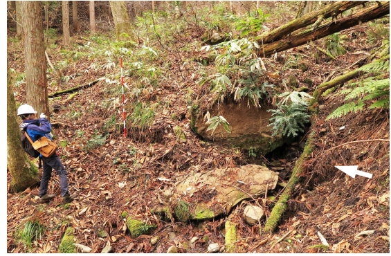
3-2-1 東側上昇を示す撓曲と転石の破壊
