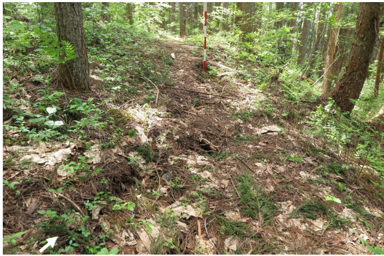
1-2-2 作業道に現れた東側上昇の亀裂・段差
