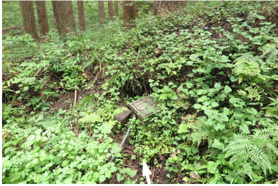
5-2-2 開口亀裂に伴う水路の変状
