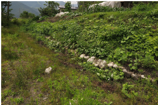
6-2-2 石積みの倒壊を伴う北側上昇を示す変状
