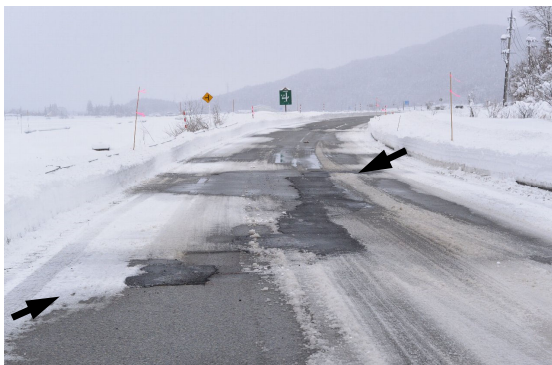
8-3-1 圧縮による路面の破損
