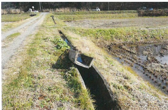
7-4-1 圧縮により飛び出した側溝水路(川合将文氏撮影)
