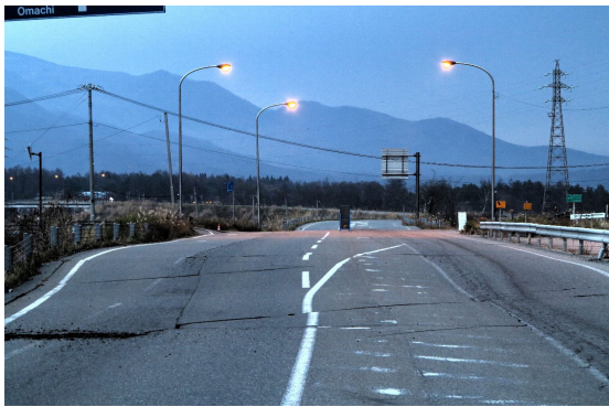
4-6-3 県道の左横ずれを伴った撓曲による変状
