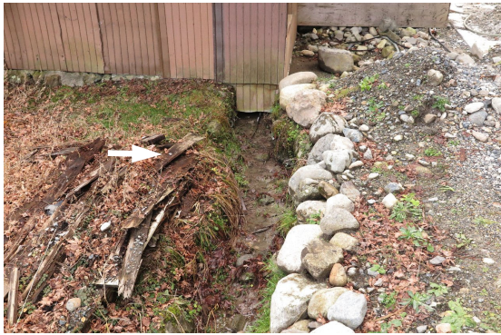
2-2-1 左横ずれを示す水路の変状
