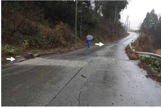
1-1-1 村道の南側上昇を示す変位
