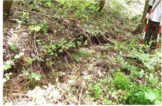
1-2-1 東側上昇を示す亀裂・段差
