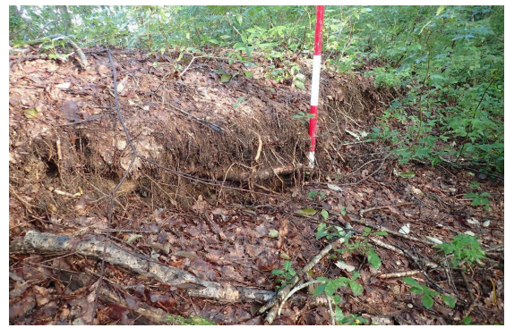
11-2-1 尾根上の西側上昇の変位を伴う亀裂
