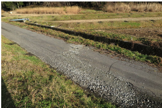
6-4-3 圧縮を示す路面の破損
