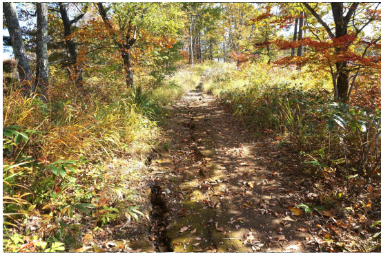
14-2-1 林道に生じた開口亀裂
