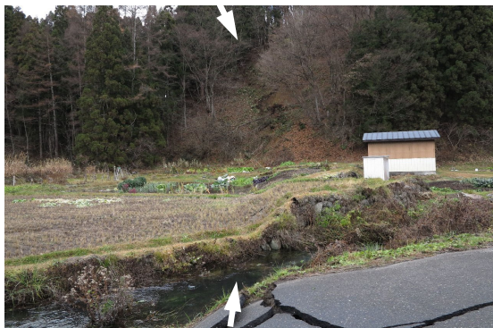
1-6-3 東側上昇を示す圃場の変位と斜面の変状(1-6-1)
