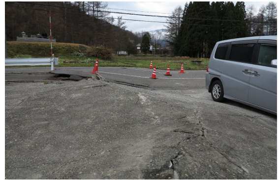
1-9-1 国道406号の東側上昇を示す変位
