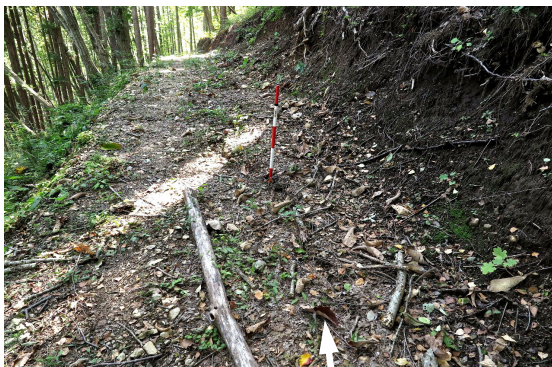
12-2-1 林道に生じた西側上昇の段差
