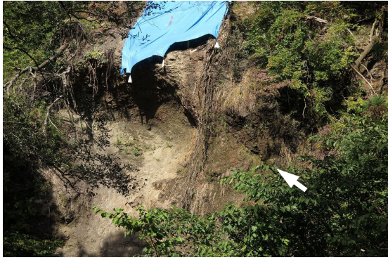
13-1-1 峰方沢右岸の断層(上部の道路を破壊する)
