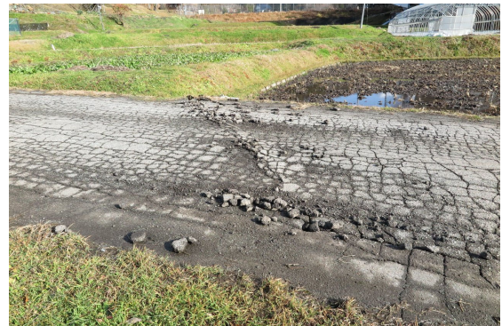
6-3-1 圧縮を示す路面の変状
