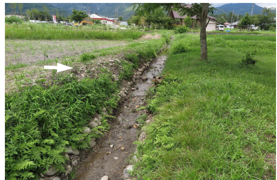
1-12-1 四十九院南の左横ずれを示す水路の変状
