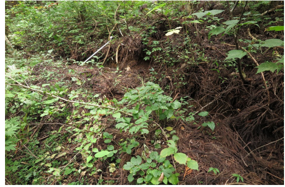
6-1-1 斜面に生じた開口亀裂
