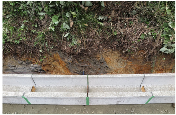
15-1-1 道路側溝改修部分に現れた粘土化した断層
