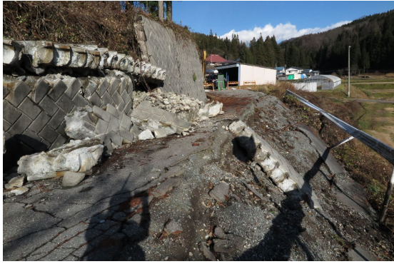
6-4-1 ブロック積み擁壁の倒壊
