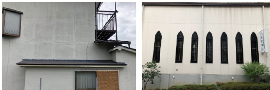
図 1 . 確認した劣化や汚れの一例
