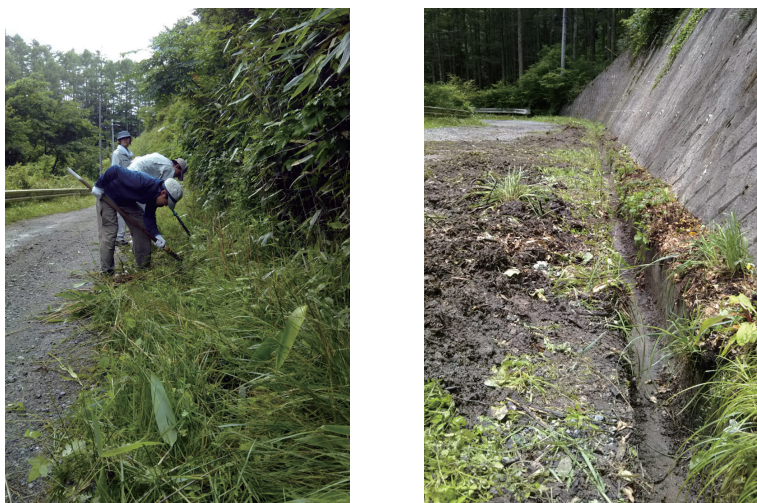
図2 林道の側溝付近の状況 左：作業前，右，浚渫および草刈の作業後。
