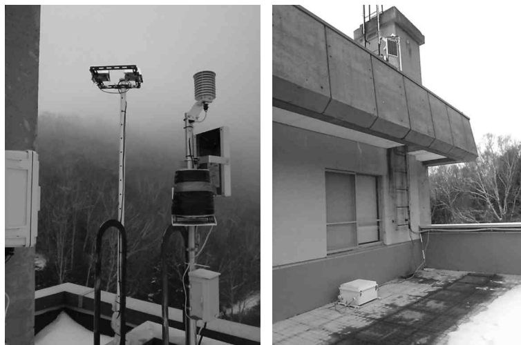
図1. 志賀自然教育研究施設に設置された光学式簡易雨滴計 左: 屋上に設置したセンサー (左側), 右: 3階ベランダに設置したPC格納箱
